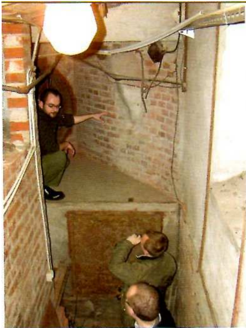
Na początku XX w. pod podłogą nawy głównej zamontowano system grzewczy. Na zdjęciu wewnątrz głównej komory.
